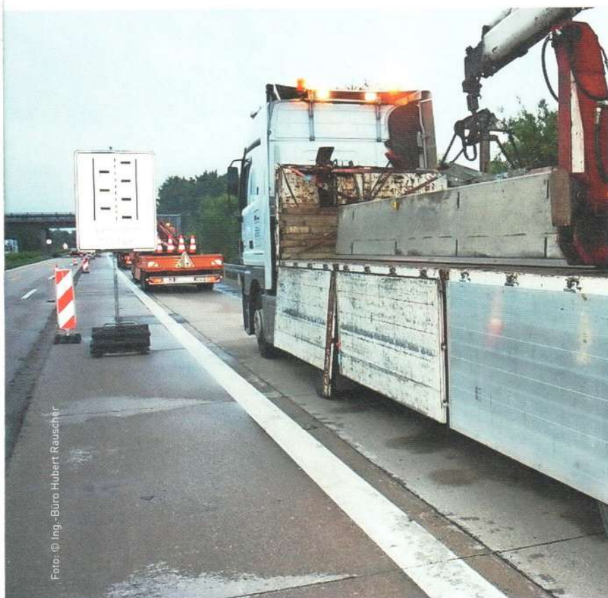
An dieser Baustelle kam es zu einem tödlichen Unfall mit einem Ladekran.
